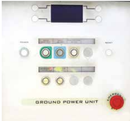
Befehlseinrichtungen am Bodenstromaggregat
