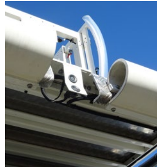
Abstandssensor an der Überladeeinrichtung
