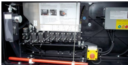
Hilfseinrichtung mit Handpumpe
