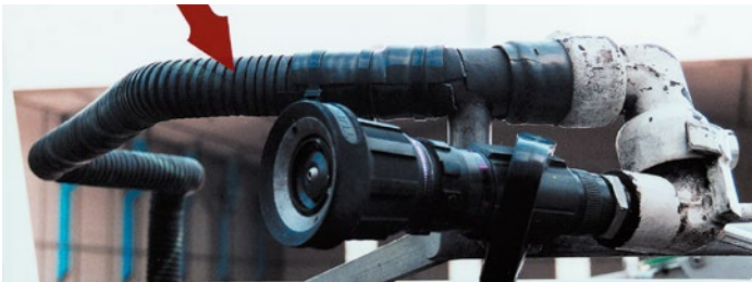
Abdeckung der Leitung für heiße Enteisungsflüssigkeit
