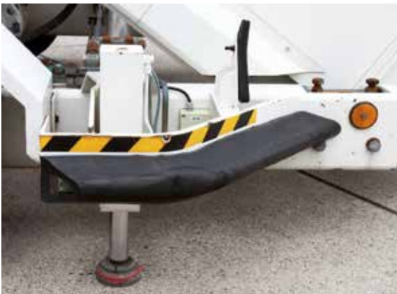
Gefahrstelle an einer Abstützeinrichtung
