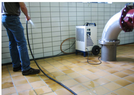
Abb. 11 Strahlwassereinwirkung auf Anschlussleitung und Betriebsmittel
