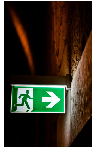
Abb. 19 Notlichtsystem als Sicherheits- und Rettungszeichenleuchten
