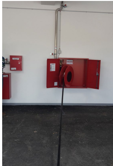
Abb. 54 Verwendung eines Wandhydranten zur Entstehungsbrand-bekämpfung
