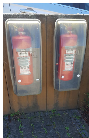
Abb. 51 Vor Witterungseinflüssen geschützte Feuerlöscher
