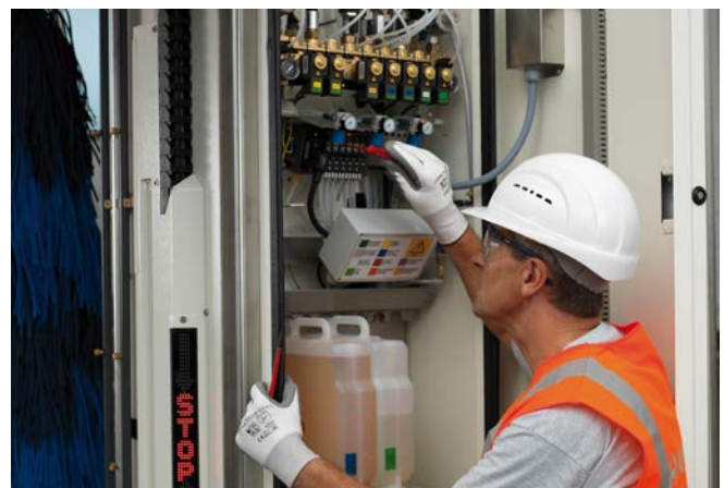
Abb. 14 Arbeiten an elektrischen Anlagen sind Elektrofachkräften vorbehalten.
