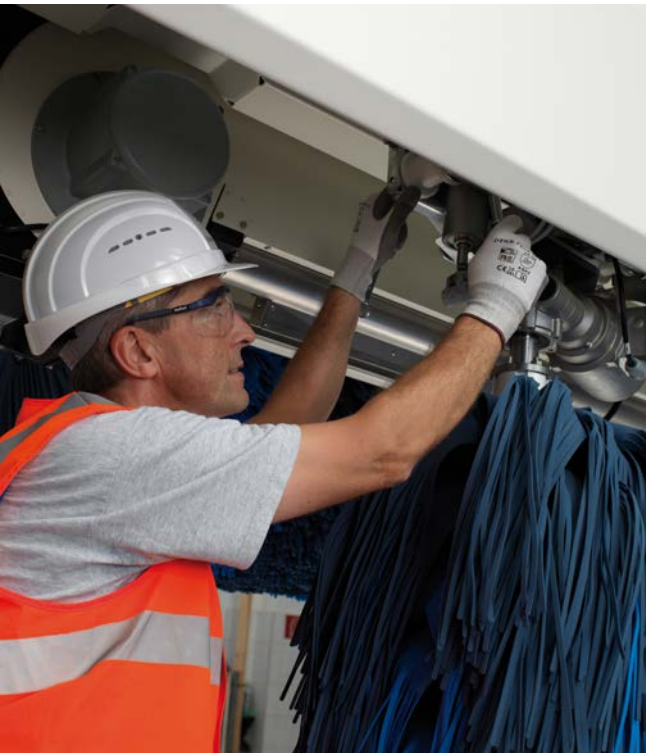
Abb. 18 Fahrzeugwaschanlagen können nur sicher betrieben werden, wenn sie regelmäßig gewartet und instandgehalten werden.
