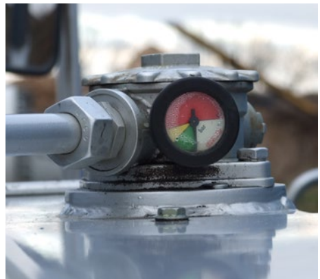
Abb. 8 Filter mit Verschmutzungsanzeige
