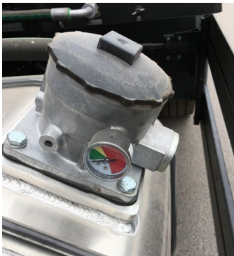
Abb. 9 Filter mit Verschmutzungsanzeige
