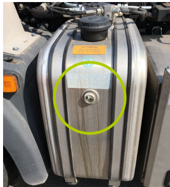
Abb. 10 Hydraulikanlage mit Füllstandanzeige
