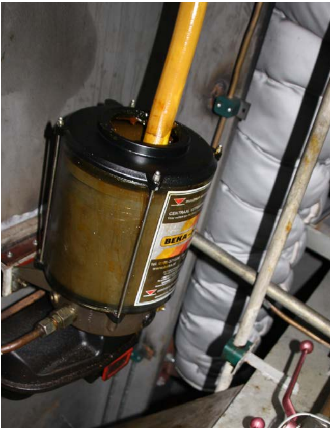
Abb. 12 Regelmäßige Wartung erhöht die Systemsicherheit
