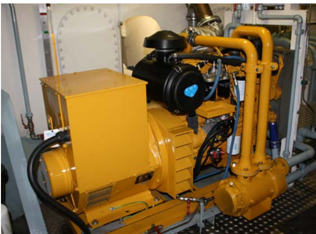
Abb. 2 Das DGUV-Regelwerk legt Prüfintervalle fest (z. B. in der DGUV Vorschrift 3 und 4)
