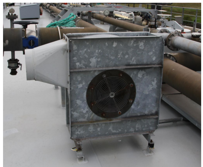
Abb.10 ... dutzende von prüfpflichtigen Ausrüstungsteilen!
