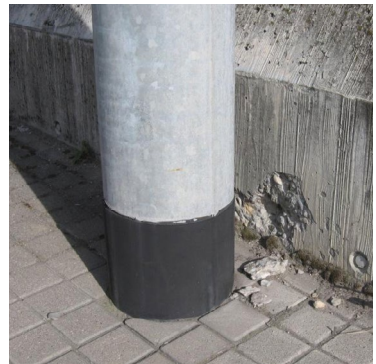
Abb. 5 Betonschaden durch Blitzentladung
