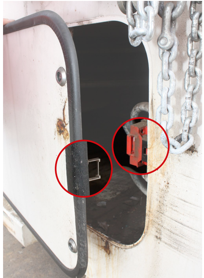
Abb. 11 Sicherheitsschalter an Zugang zur Wartung und Reinigung
