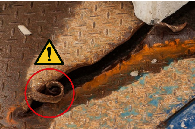
Abb. 27: Stich-, Schnitt- und Stolperstelle an aufgerissenem IP-Boden
