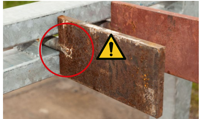
Abb. 19: Ungeeignete Schraubarretierung: unterdimensionierter Führungsschaft, keine Verdrehsicherung, zu kleine Auflageflächen
