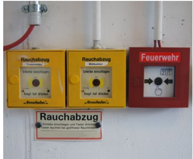
Abb. 15 Betätigungs- und Meldeeinrichtungen des Brandschutzes
