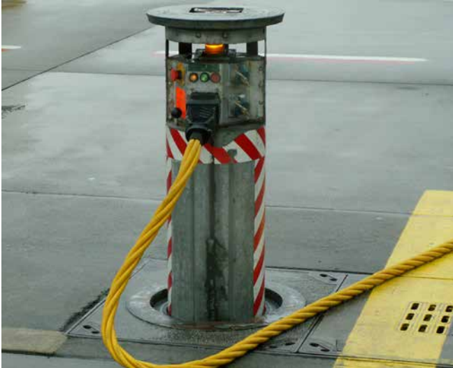
Abb. 32 Ortsfeste Stromversorgung für Luftfahrzeuge
