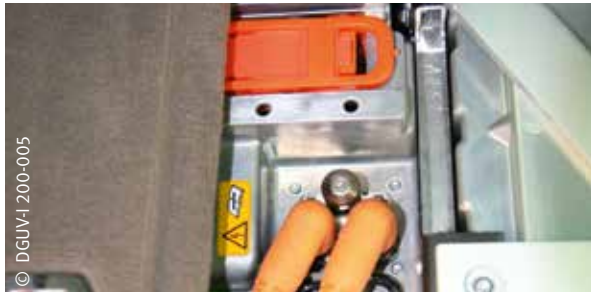
Trennstecker/Disconnecter der Hochvoltbatterie
